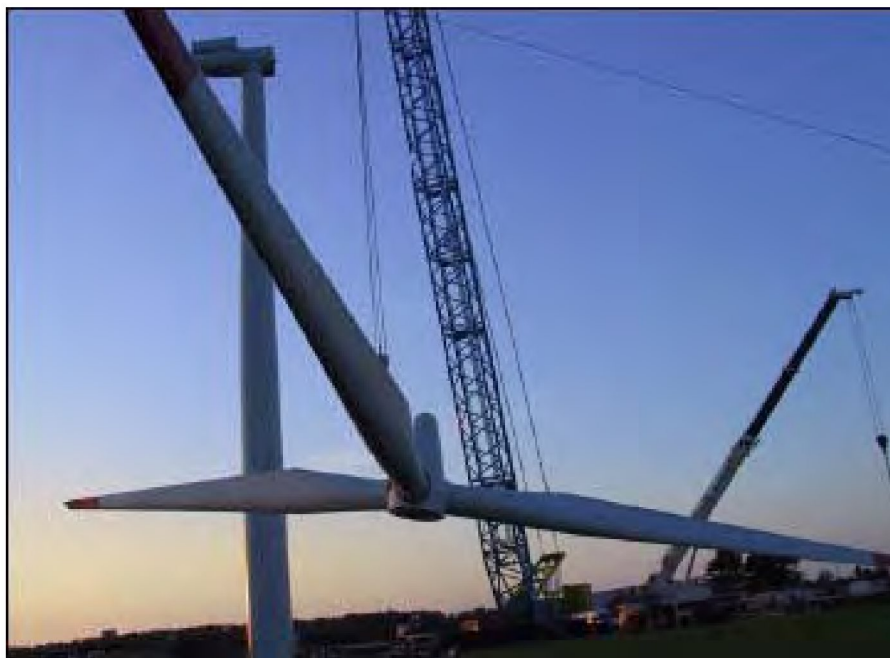
Figur 5.9 Oppstilling av turbin type Siemens 2.3 MW
