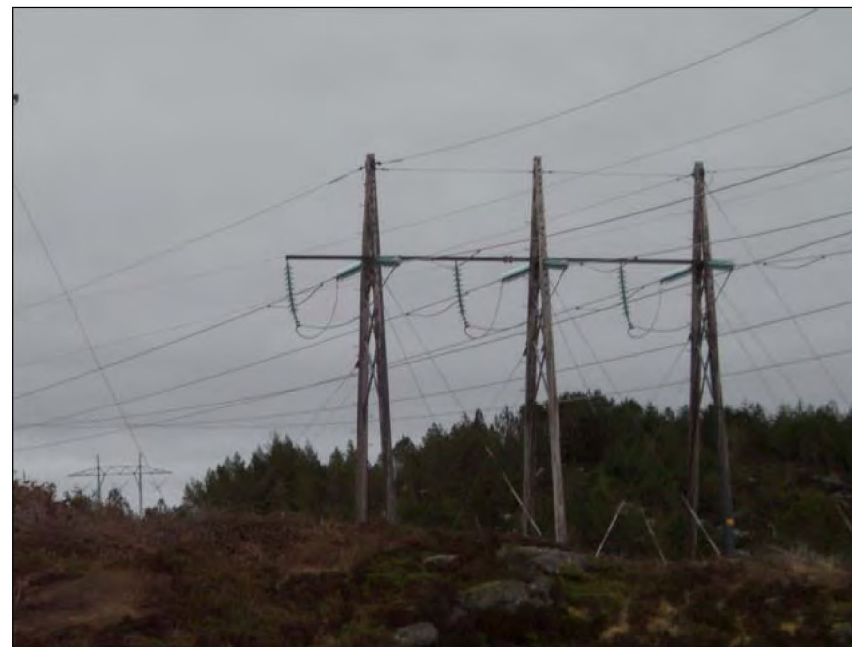
Figur 5.8 132 kV nettet ved Kollsnesanlegget.
