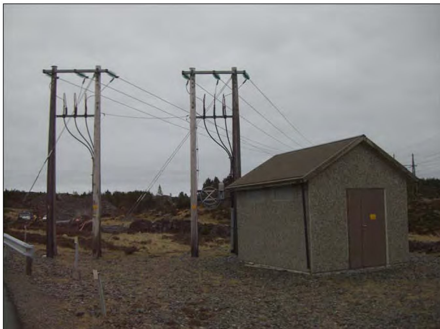
Figur 5.7 22 kV stasjon ved Kollsnesanlegget
