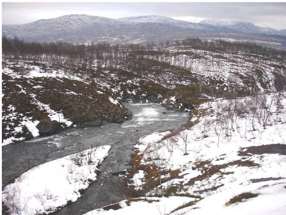
Figur 2.6 Etter kryssingen fortsetter rørgaten på venstre side i terrenget.
