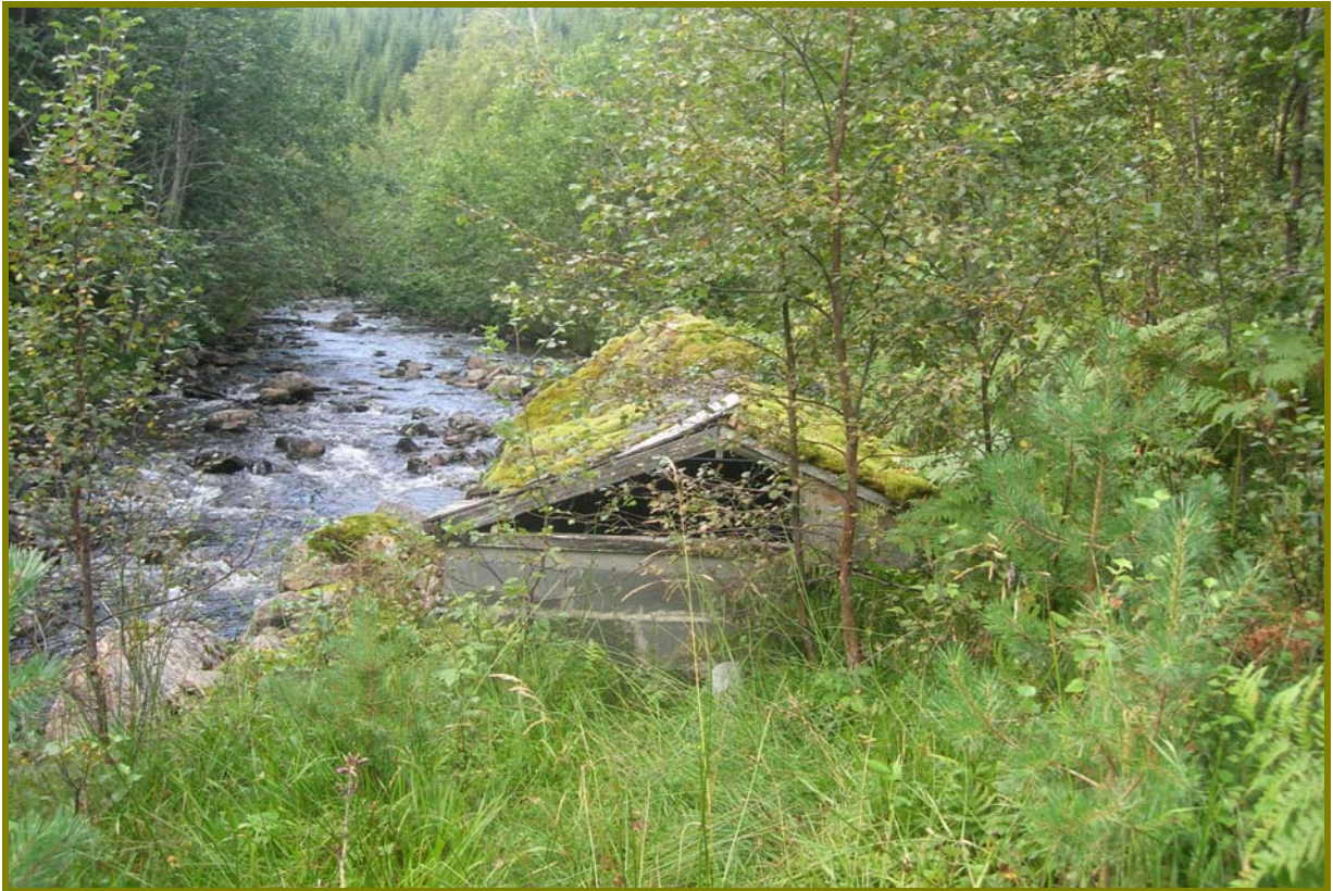
Bildet viser inntaket for drikkevann i Herredsdalselva ved en middesstor vannføring (ca.600 l/s)
