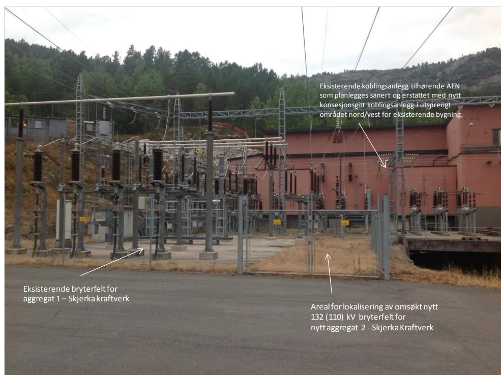
Fig 6-4b Foto av eksisterende bryterfelt aggregat 1 – Skjerka kraftverk.
