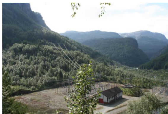
Figur 33. Trafostasjon og kreftledinger i Børdalen.
