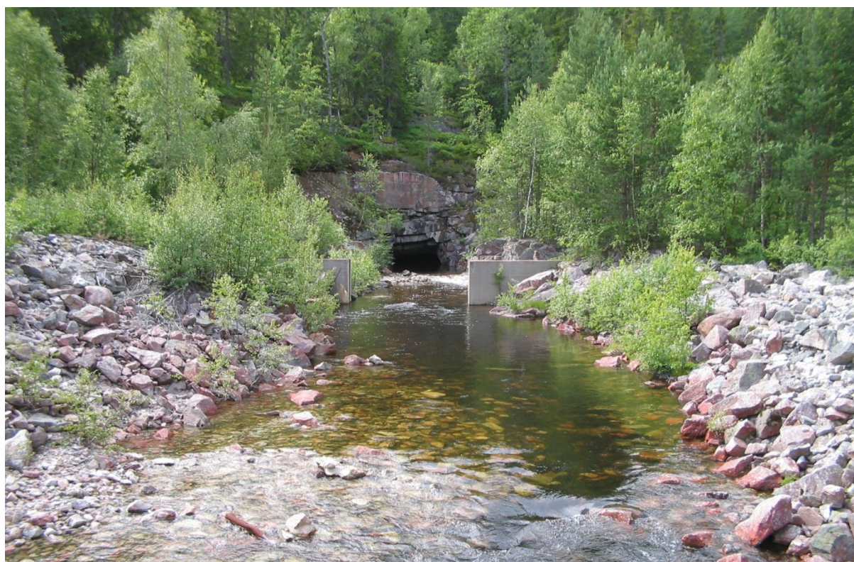
Bilde 1. Omløpsluke Nesvatn. Tapping av minstevannføring.
