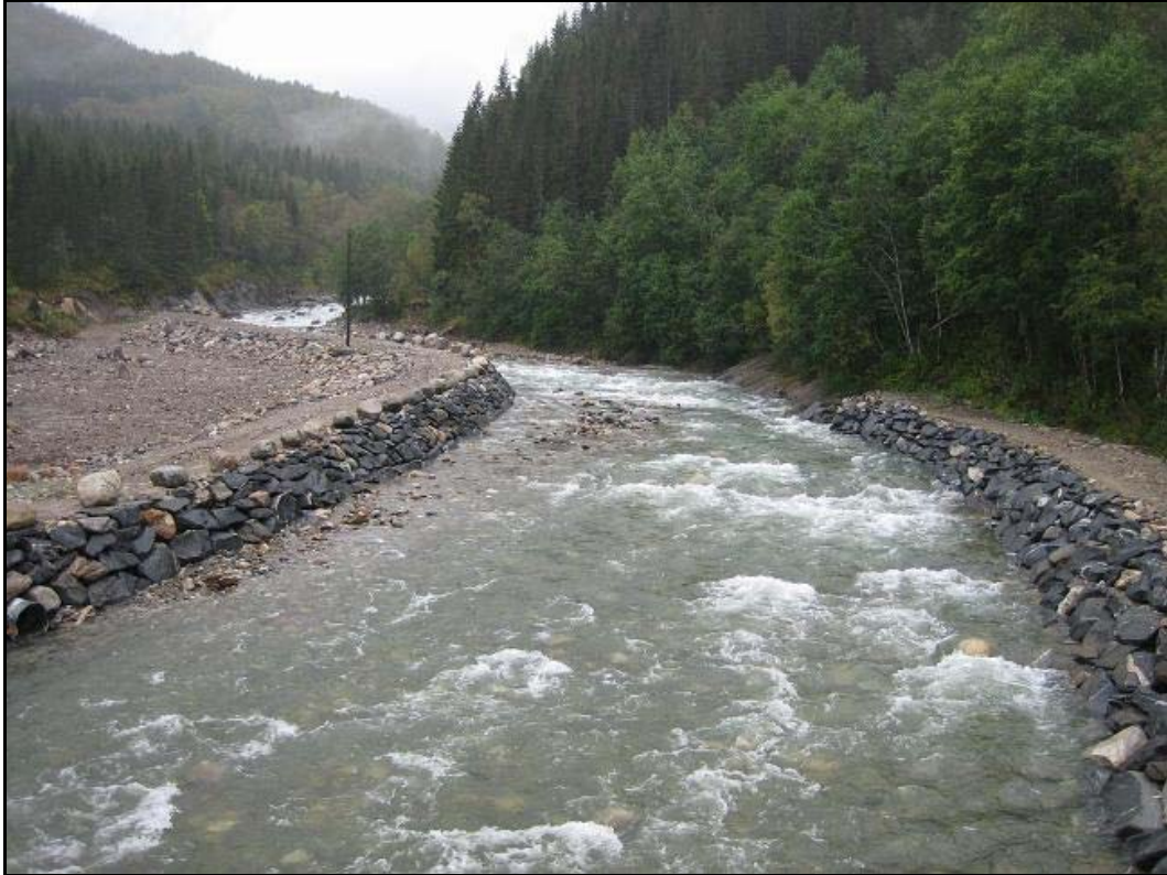
Foto 5. Bildet viser nedre del av elva, like oppstrøms utløpet i Beiarfjorden, hvor det er utført elveforebygging langs elvebreddene er for å hindre erosjon.
