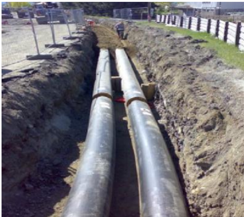
Figur 5: Fjernvarmegrøft i praksis
