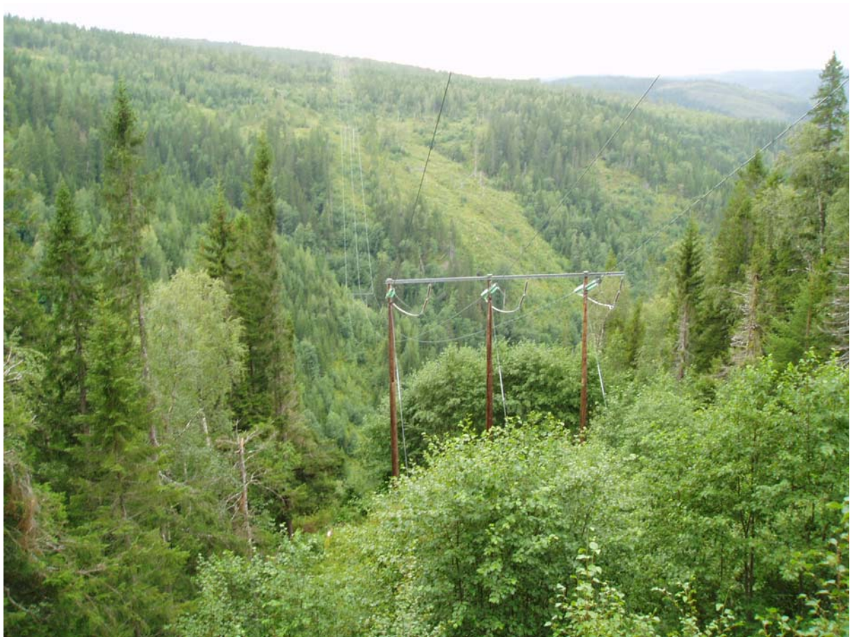
Figur 24 24 kV linje krysses omtrent ved rørgatens høybrekk (2,8 km fra inntak)
