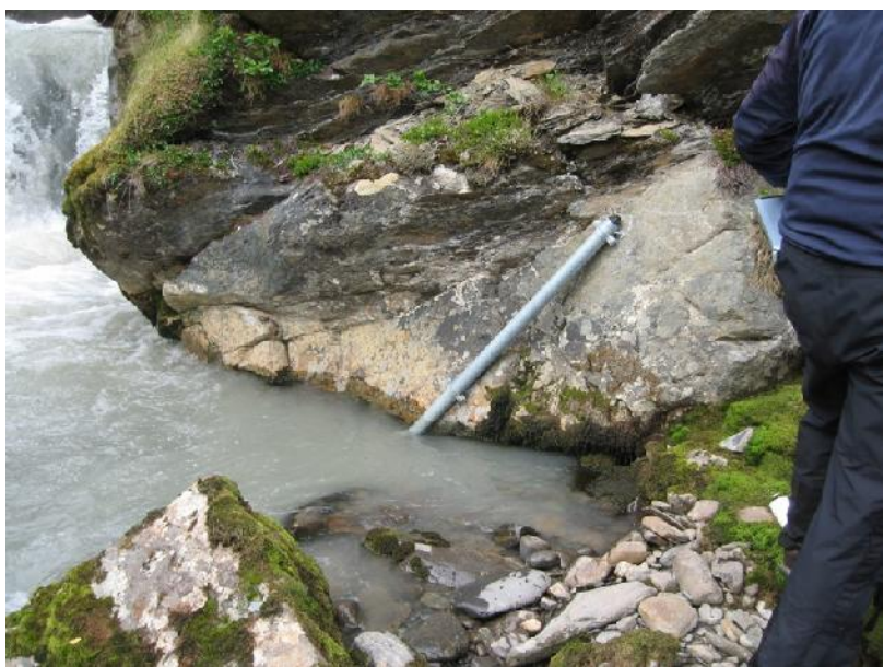
Bilde 9: Vannmålingsutstyr montert i Iselva på kote 173. Foto: Elvekraft
