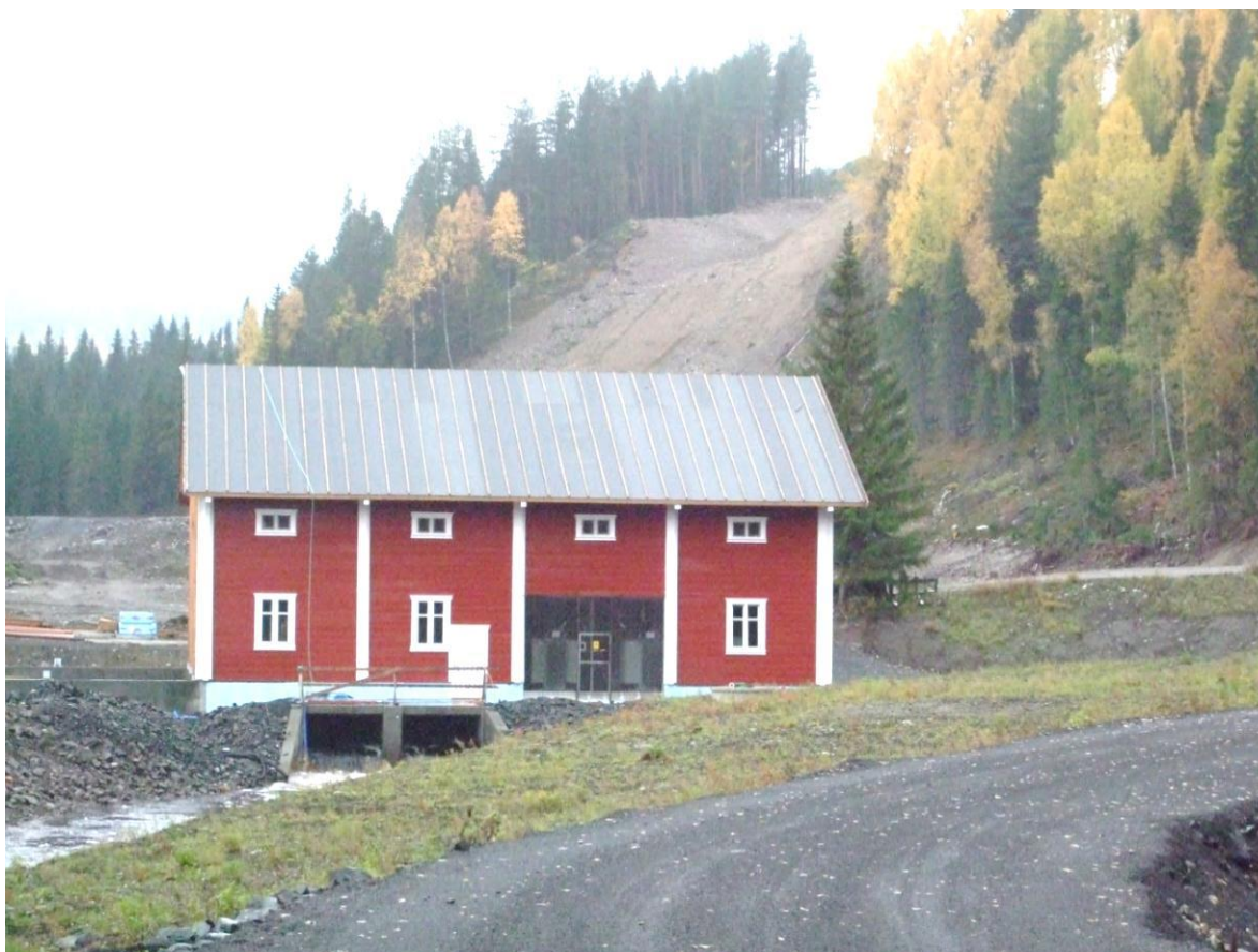
Bilde 1: Veslefallet Kraftverk under utbygging. Kolåsmyrfallet Kraftverk vil få tilnærmet samme arkitektoniske utseende.
