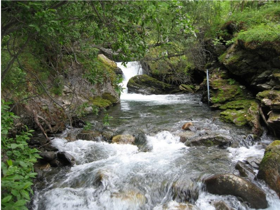
Bilde 2: Vannmåler montert i Nomedalselva. Foto: Elvekraft.
