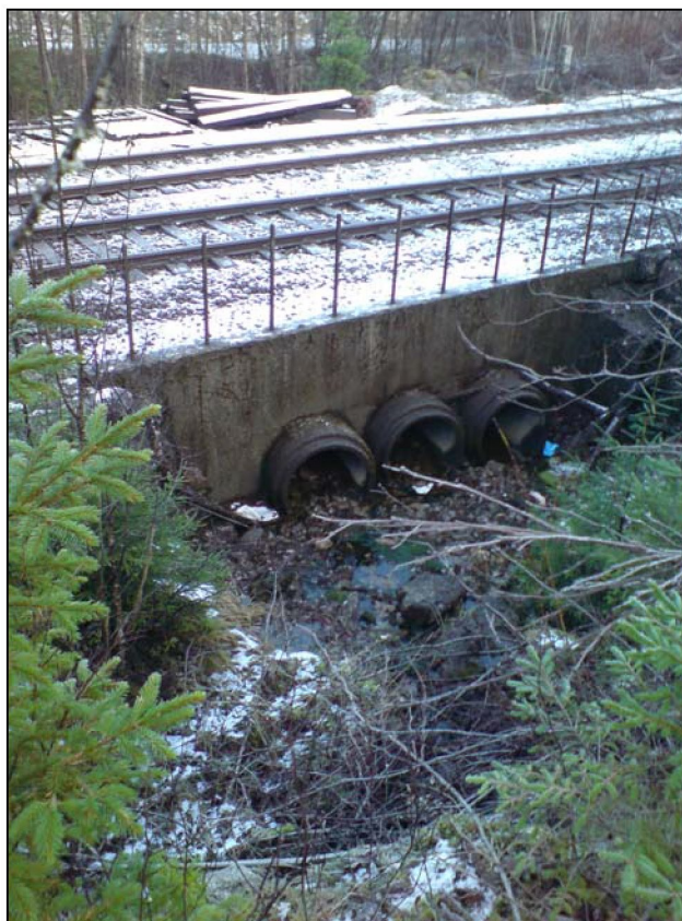
Foto 9 – Røyr gjennom jernbanefyllinga. I avtalen med Jernbaneverket har fallrettslaget fått løyve til å nytte eit av drenerøyra til dei to trykkrøyra til kraftverket. (foto 12.11.2007).
