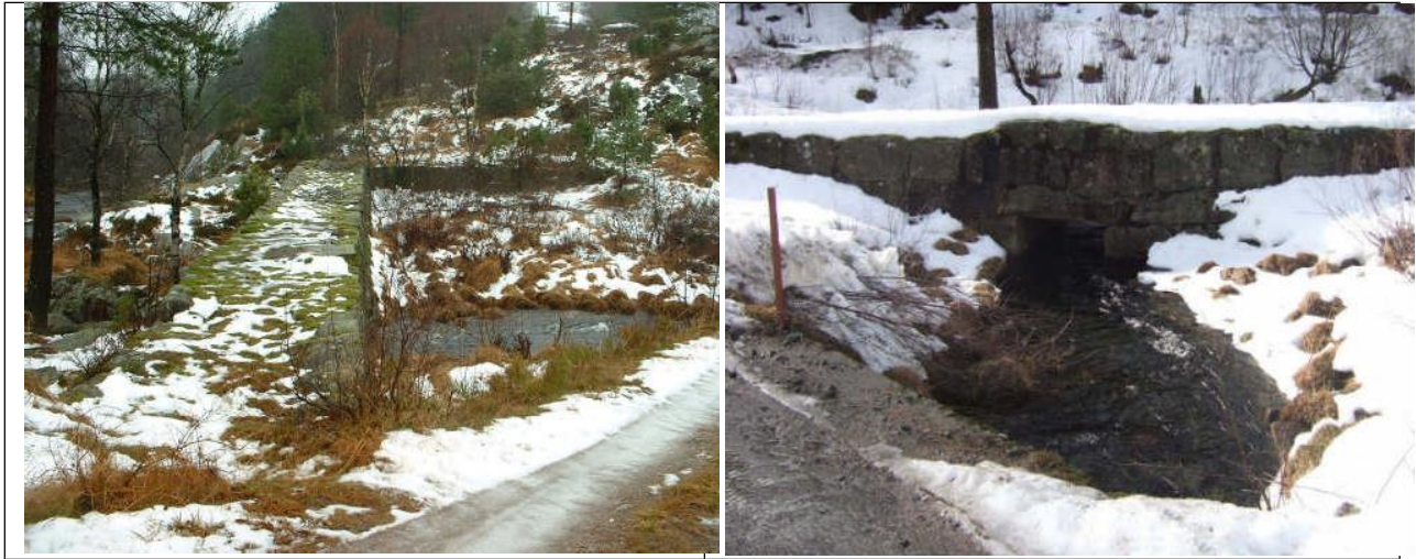
FIGUR 3: BILDE VISER DAMMEN I UTLØPET FRA STOREVANNET SOM ER I MEGET GOD STAND OG FLOMDEMPER FORTSATT DE STØRSTE FLOMMENE BETYDELIG.
