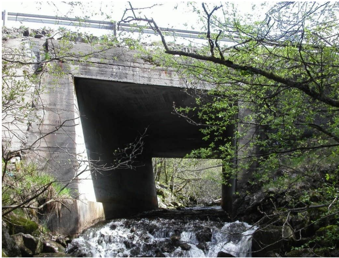
FIGUR 10: BEKKEN KRYSSER UNDER E39, BILDET VISES DEN EKSISTERENDE KULVERTEN SOM LIGGER OPPSTRØMS INNTAKET
