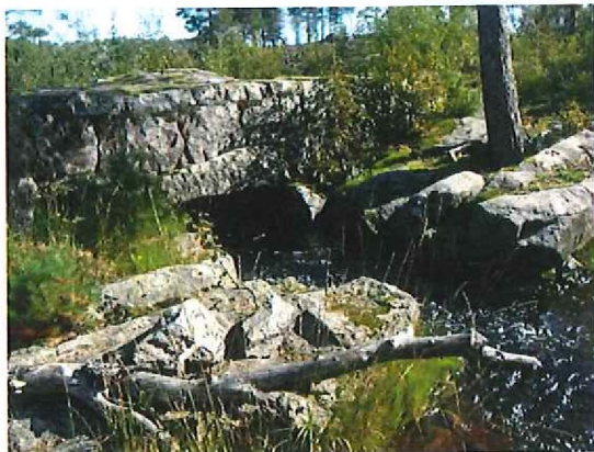
Figur 3. Eksisterende stem ved Rødlendsvannet i nordre del av Storevatnet ønskes brukt til regulering av minstevannføringen mot Grubbevannet. Dette kan bli et vandringshinder for ål.
