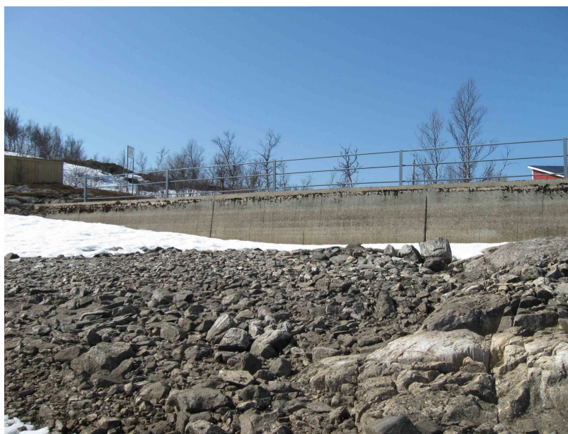
Bilde 12 Strandsone nedenfor demning på vannside.
