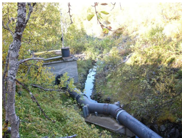
Bilde 6 Øverste del av ledning mot rørbruddsventil
