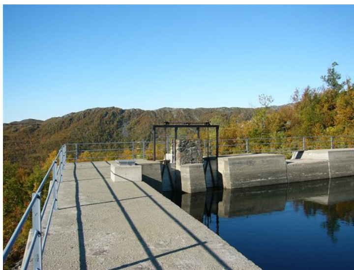
Bilde 1 flomluker og overløp magasin Damvatn
