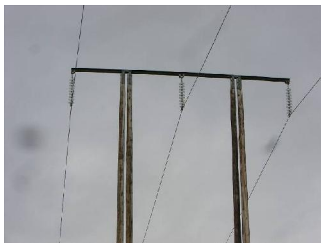
66 kV-linje ved kote 300. Foto: Elvekraft
