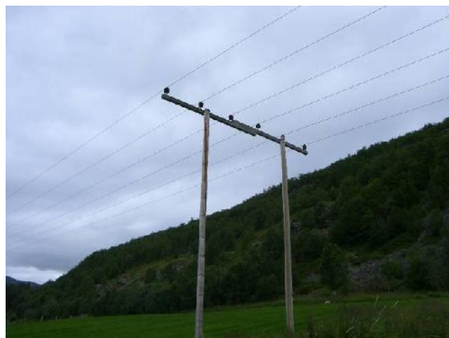
22 kV-linje ved kote 33. Foto: Elvekraft
