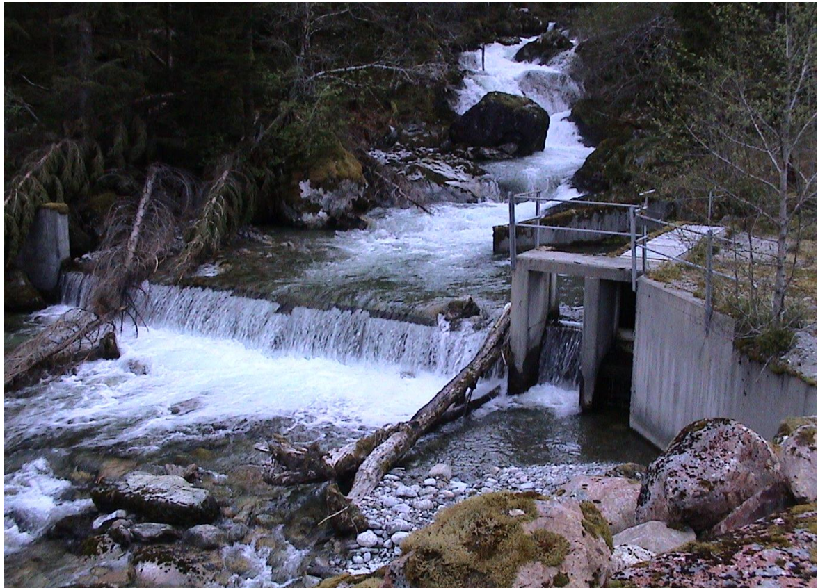
Bilde 6.1 Indre Fjærland Vassverks inntak
