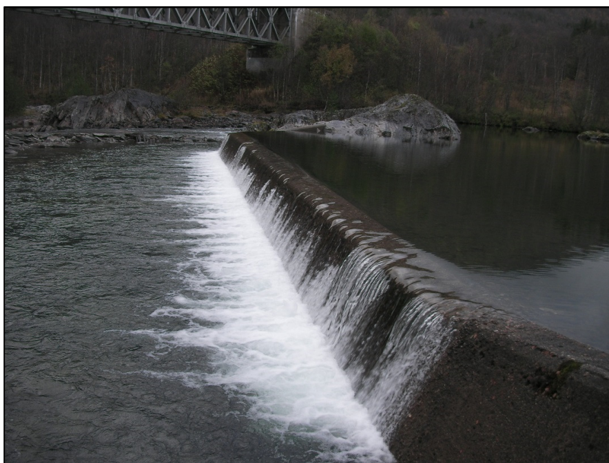
Figur 2 Betongterskel i Ranaelva kote 245.
