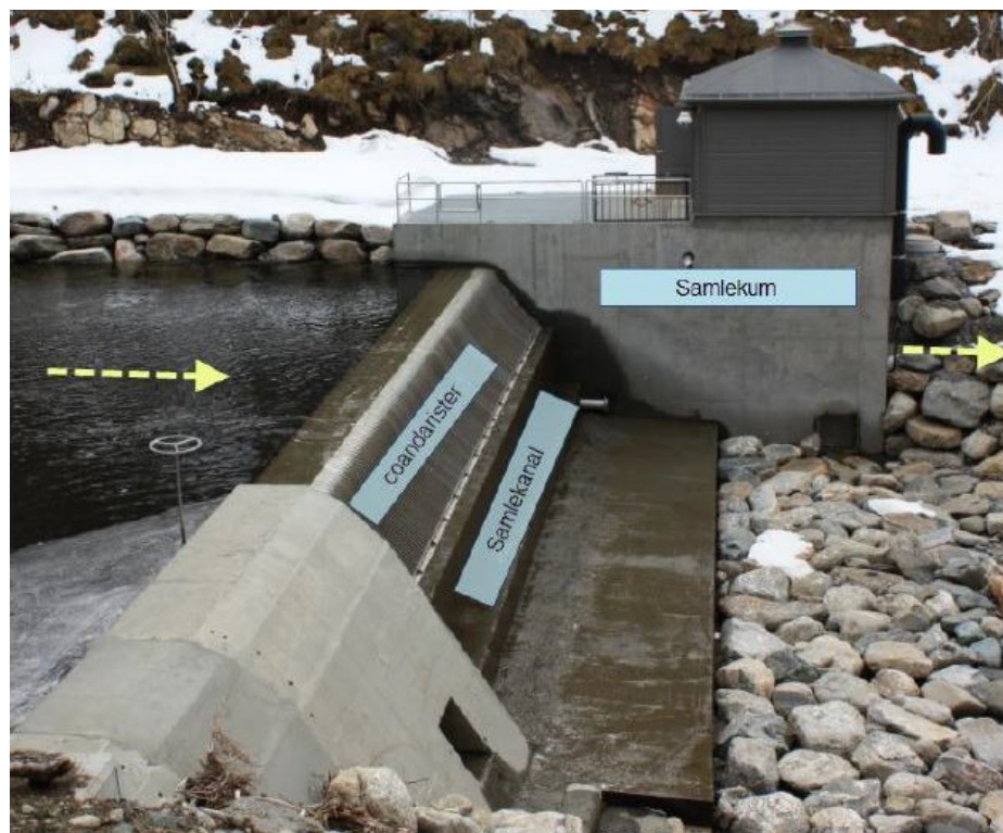
Bilde 1: Coandainntak i Dyrkorn kraftverk i Dyrkornelva i Stordal kommune, Møre og Romsdal fylke. Foto etter tillatelse: Henrik Opaker, Norconsult.
