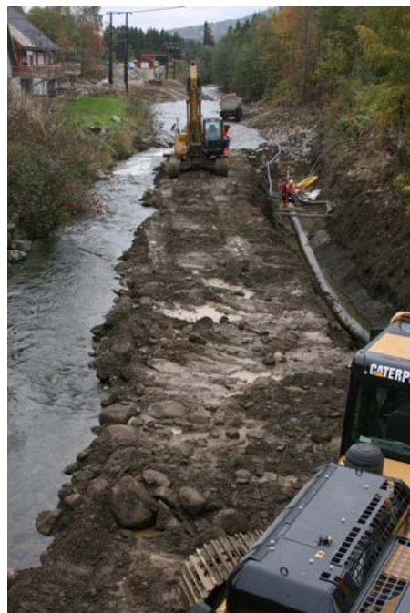
Bilde 1. Graving i Gausa/Vesleelva nedenfor Segalstad bru den 24. sept. 2008. (Foto: Finn Gregersen)
