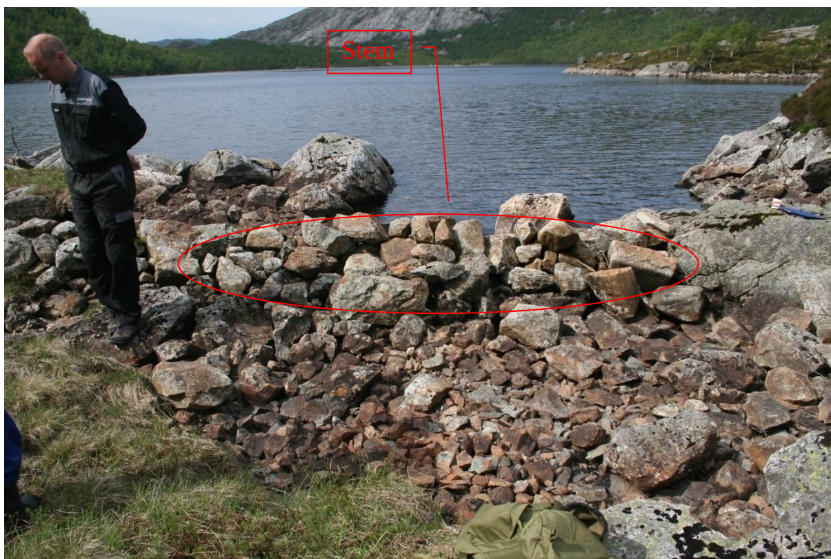
FIGUR 10: DEN GAMLE STEMMEN. HØYDEN PÅ DET MARKERTE OMRÅDET ER CA 1 M. HØYDEN ER AVTAGENDE MOT VENSTRE. OMRÅDET NEDSTRØMS STEMMEN TYDER PÅ LEKASJE OG OVERLØP.
