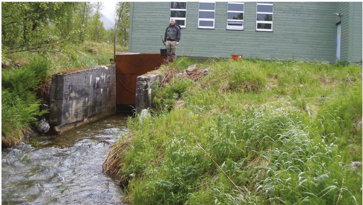
Bilde 2 Utløpskanalen til Lovik kraftstasjon. Vannføring: ca. 0,75 m 3 /s.
