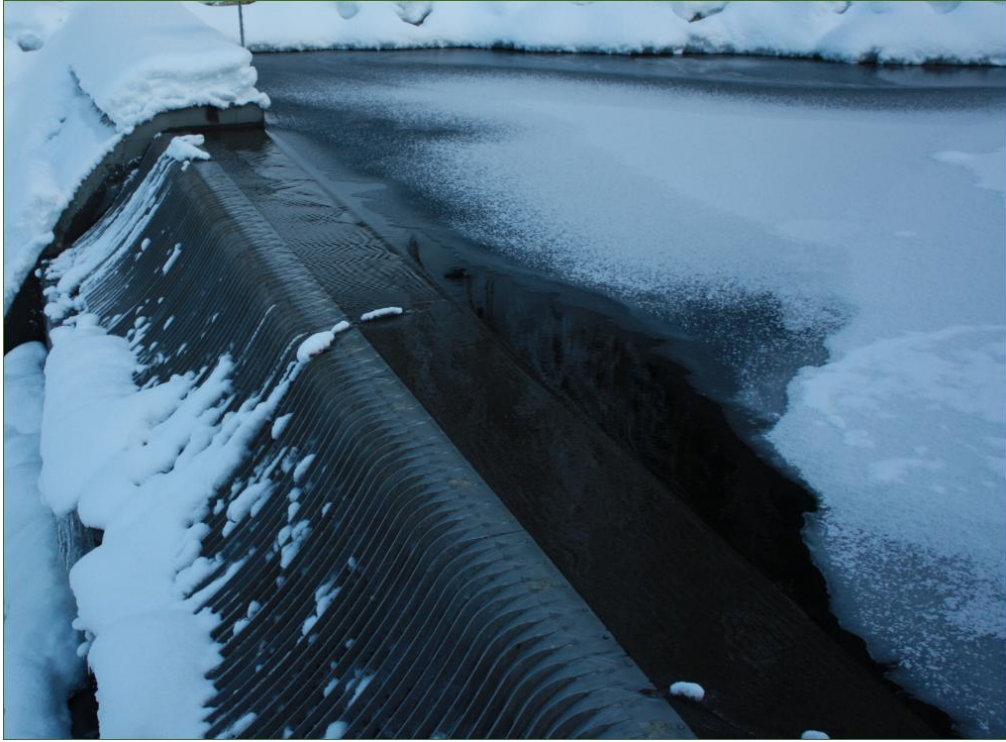
Figur 2.2.4.4 Coandainntak i drift ein kald vinterdag med låg vassføring.
