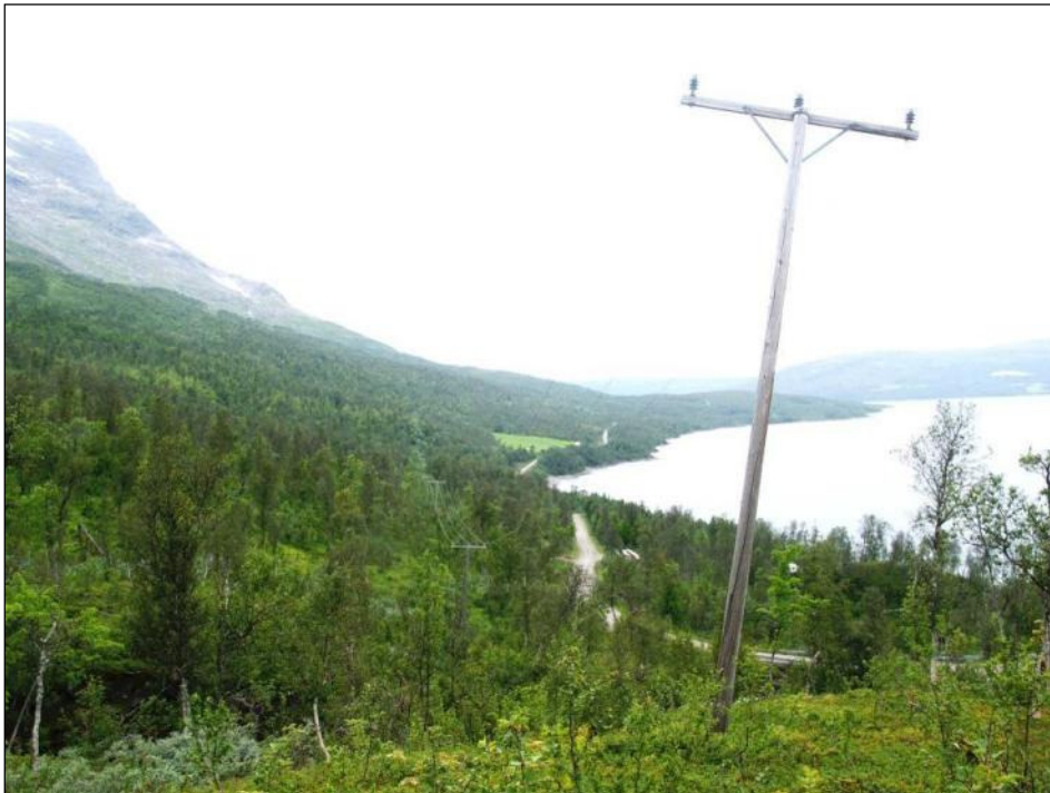
Figur 2-18. 22kV linje Øvre Røssåga – Hattfjelldal. Foto: Sweco Norge AS.
