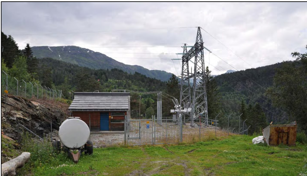
Figur 11. Eksisterende transformatorstasjon ved Stuve.
