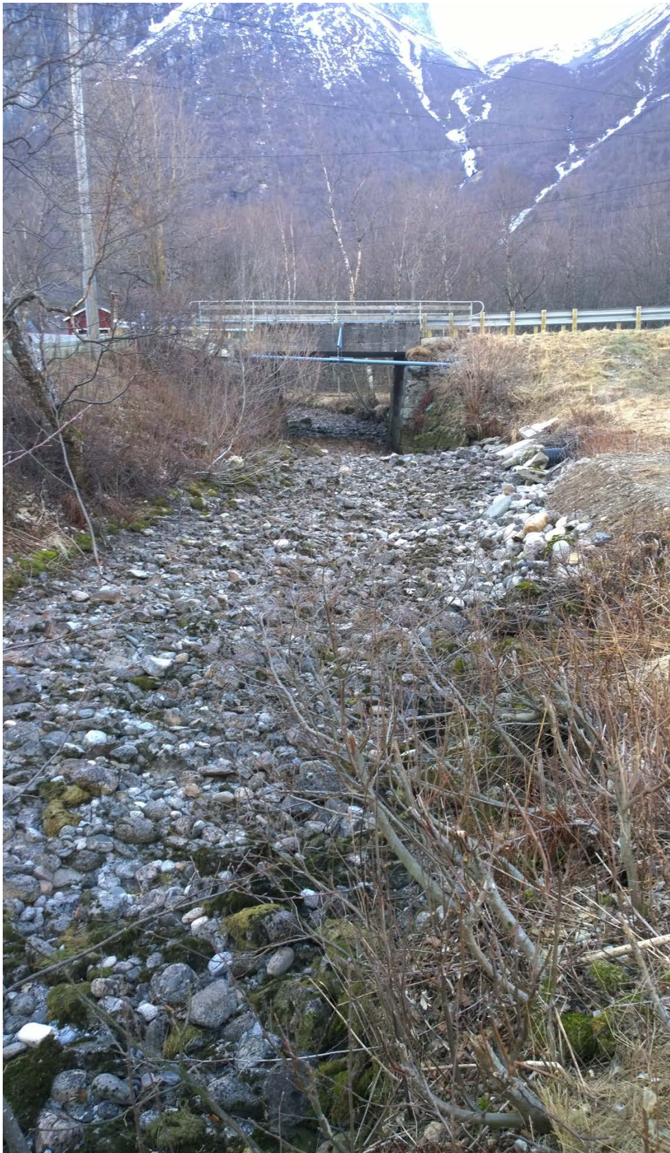
Bilde nr.7; Bilde viser tørrlagt elv der Fylkesveg 312 krysser elv. Typisk for elv 4 – 6 uker hver vinter. (bilde tatt 26.02.2014)
