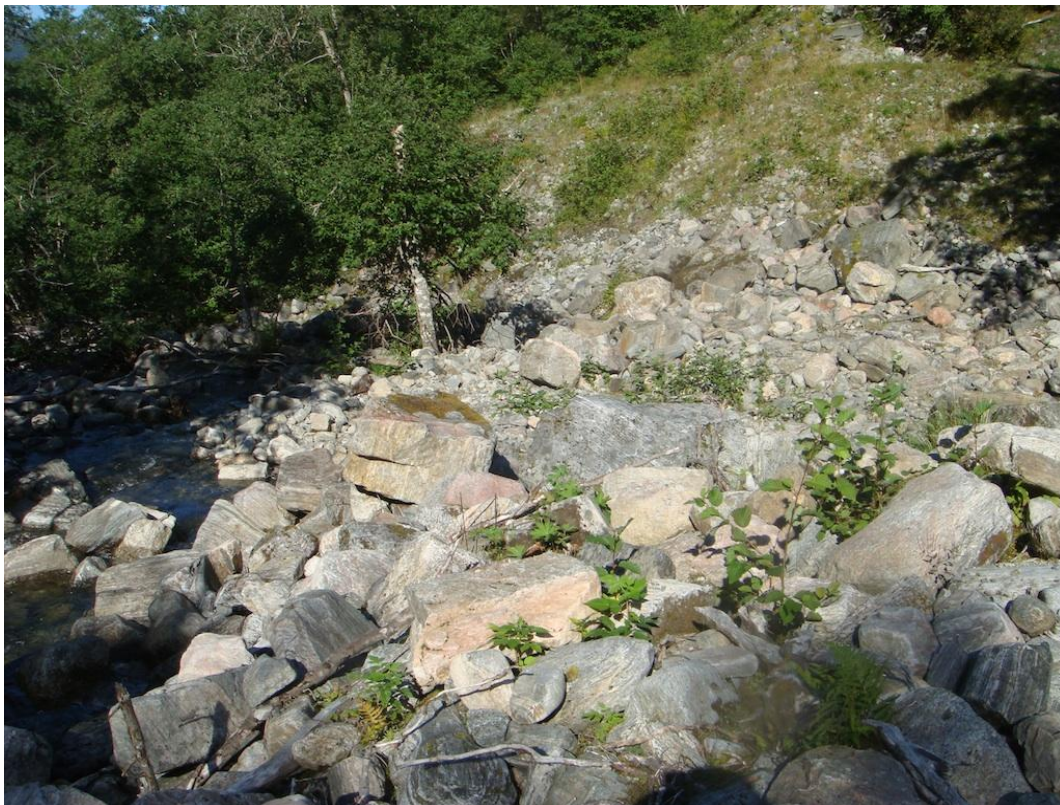
Bildet viser at fyllingen fra veiskjæringen noen steder går ned i selve elven. (Foto: Geir Frode Langelo ©, 1.september 08).
