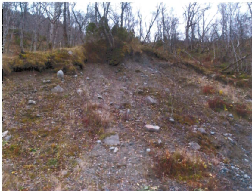
Foto 2: Grunn erosjon langs skogsveien
