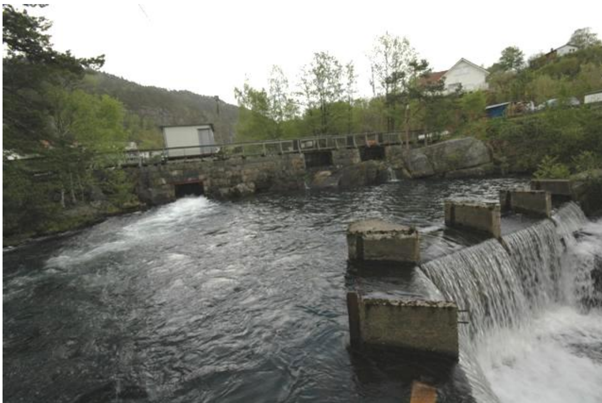
Figur 4 I bakre del av bildet mot Hølen og Selura, sees dam med storluke. Elveløp er t.h. i bildet. Inntaksdammen t.v. forsetter mot nedlagt kraftverket for øvre del av Selurelva. Jf. fig. 5.
