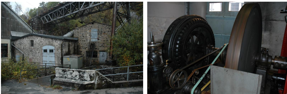
Figur 3-4. Bilde 3 t.v. kraftstasjonen. Bilde 4 t.h. generatoren i kraftverksbygningen.
