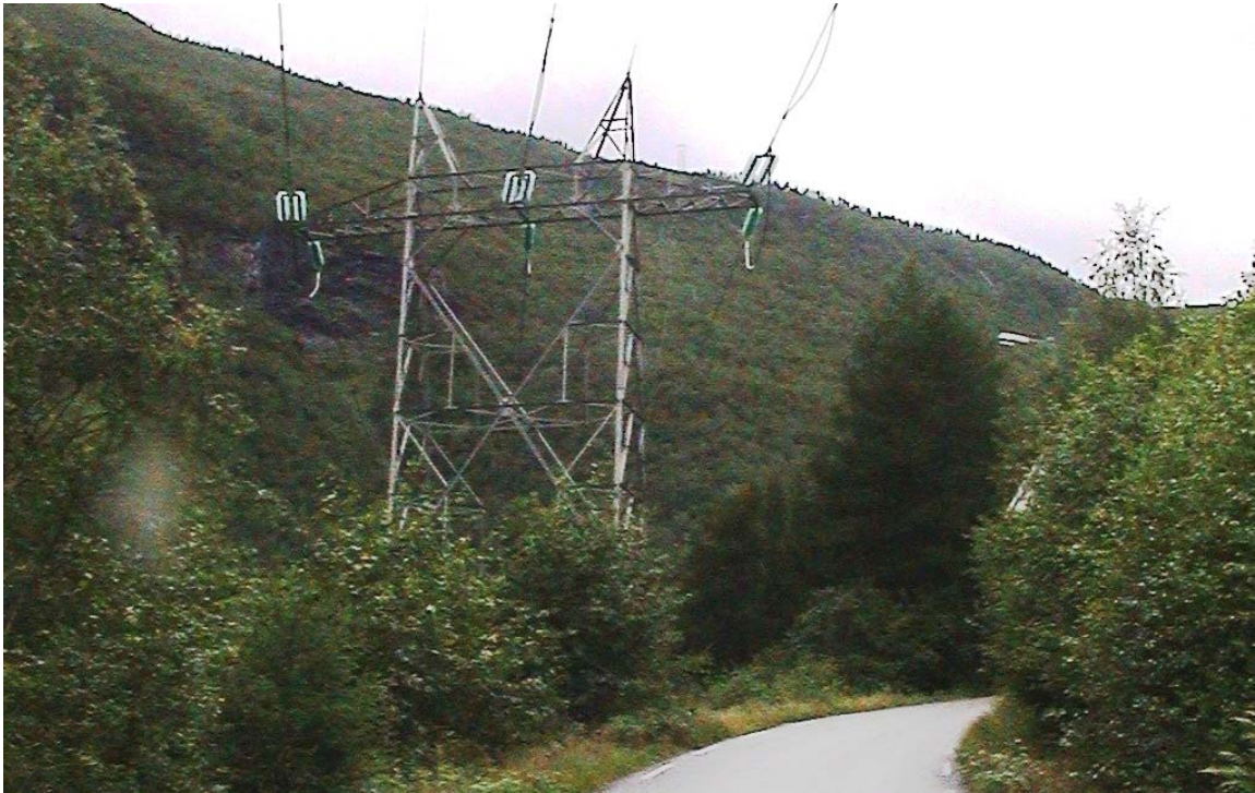
Bilde av 300 kV høyspentmast i Fardalen
