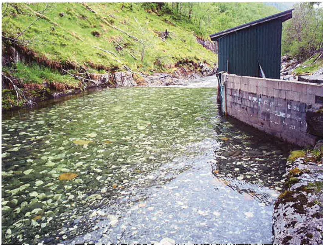
Bilde 11: Inntak for smoltanlegg. Merk at inntaket er fylt av sedimenter
