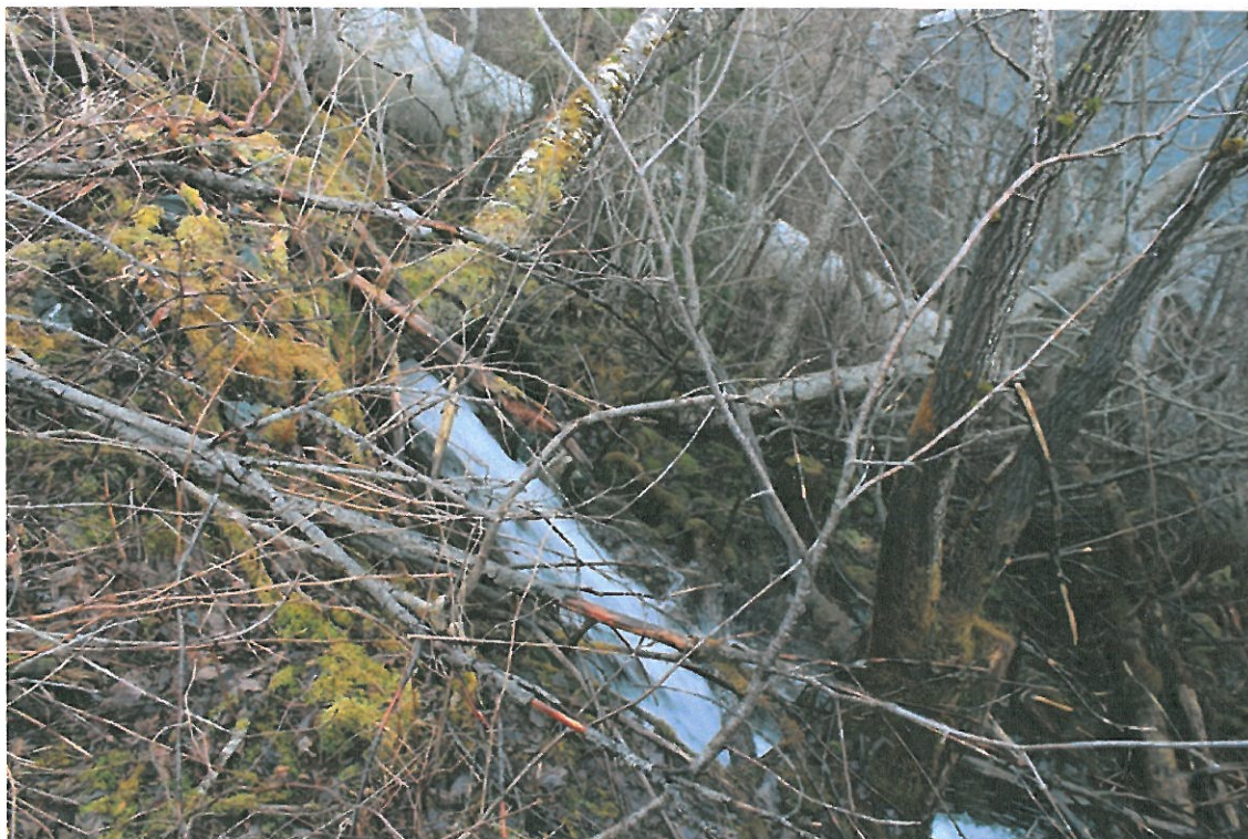
Figur 1 Lekkasje fra lukehuset til Sagbergfossen kraftverk kommer ut i lia ovenfor kraftstasjonen. Rørgata i bakgrunnen.
