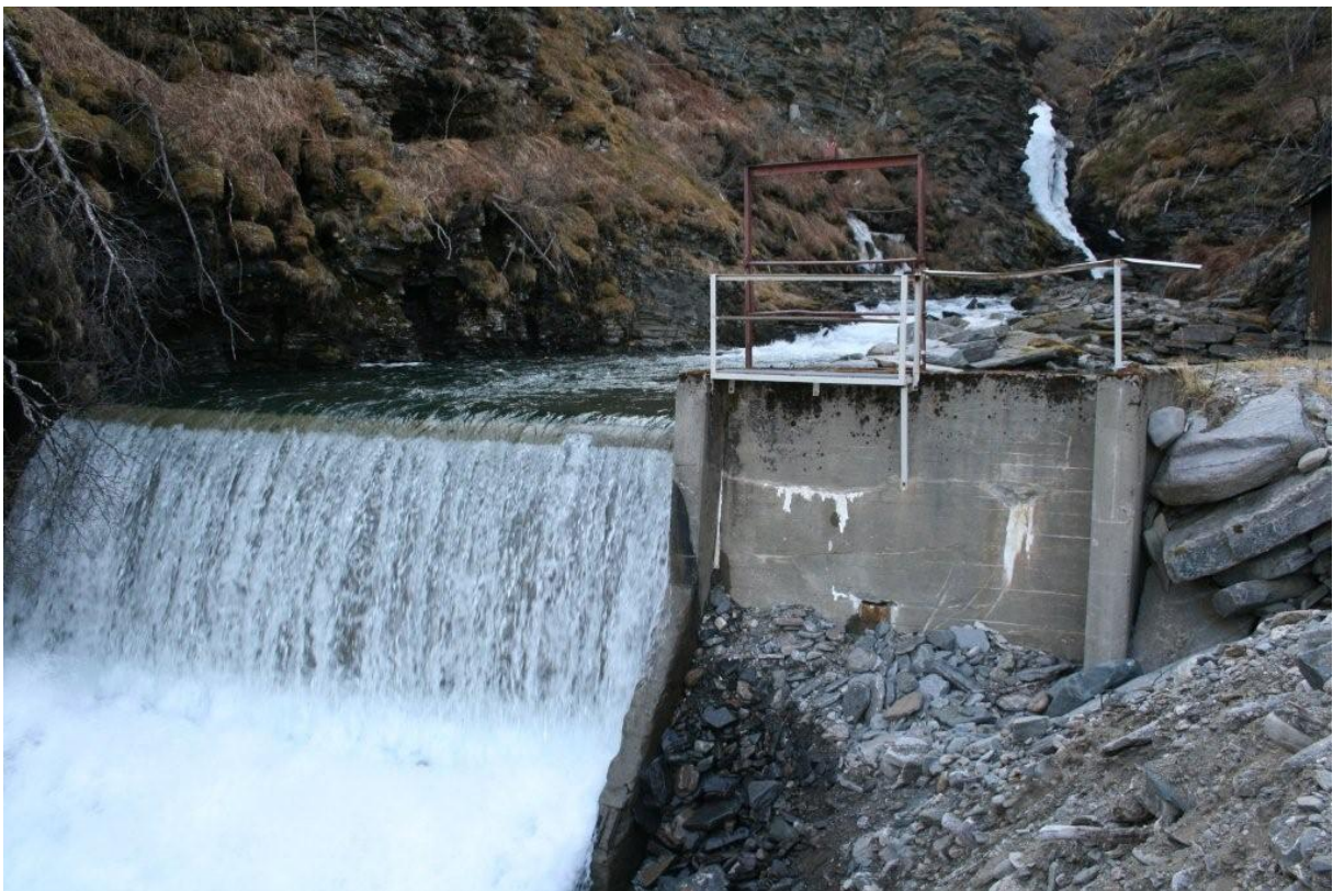
Tverrdalselva inntak vannverk, 22.05.09, Stor vannføring, 3000 l/s. Foto: Elvekraft.
