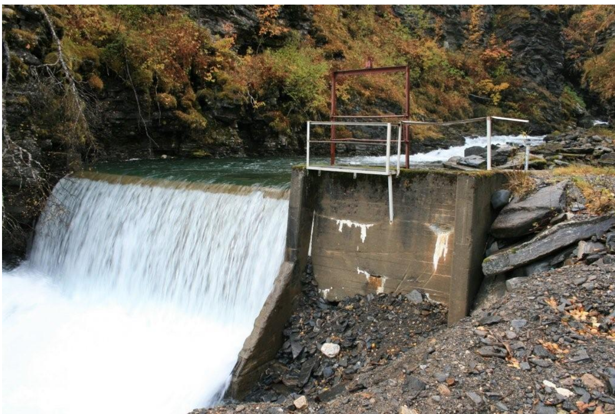
Tverrdalselva inntak vannverk, 27.09.09, stor vannføring, 4000 l/s. Foto: Elvekraft.
