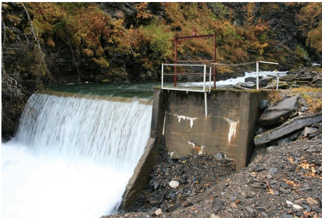
Figur 3-8 Endelig vandringshinder ved hovedinntaket for drikkevannskilde. Foto: Bekk og Strøm.
