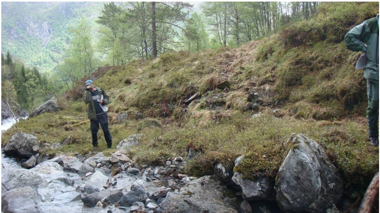
Turbinrøret fra hovedinntak I kommer ut fra inntak i høyre nedkant i bildet. Røret legges i fjellgrøft gjennom åsryggen på bildet.
