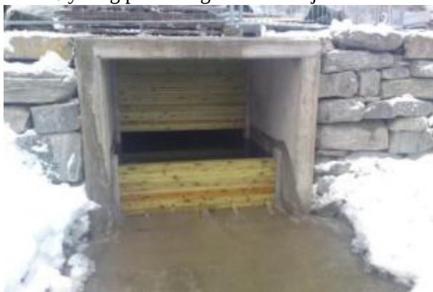
Bildet 11 viser et eksempel på utløp (kulvert) fra en kraftstasjon som fører vannet videre ut i elven. Her vist med støydemping av lyd fra turbinen ut mot omgivelsene.
