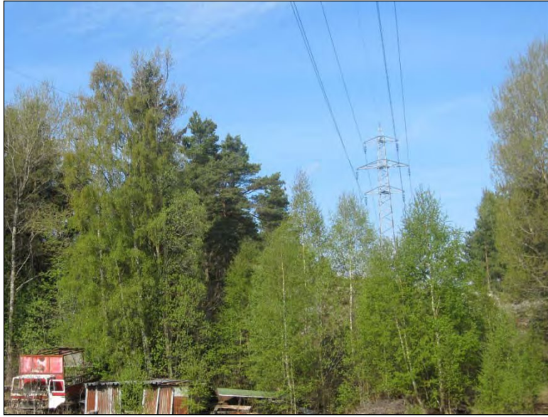
Figur 2. Foto av eks. 52 kV (Brekke ledningen) Vestre ende av ledningen inn mot Gyldenløve (Halden). To kurs stålmast.
