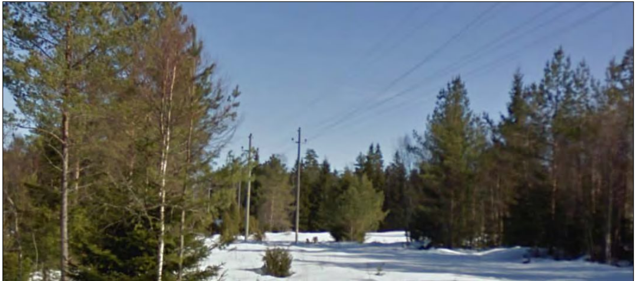
Figur 30. Foto av Fortum Distribusjon sine eksisterende parallelle 22 kV ledninger. Ny 132 kV ledning føres parallelt og sør for disse to ledningene i en lengde på ca. 700 - 800 m. Horizontal avstand ca. 8-10 m.
