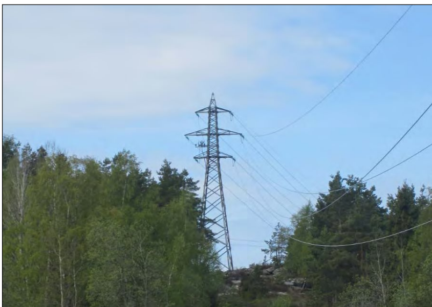
Figur 12. Fortum sin eks. 52/22 kV kabelendemast nord-vest for 170/131 (Øbergveien 27A).
