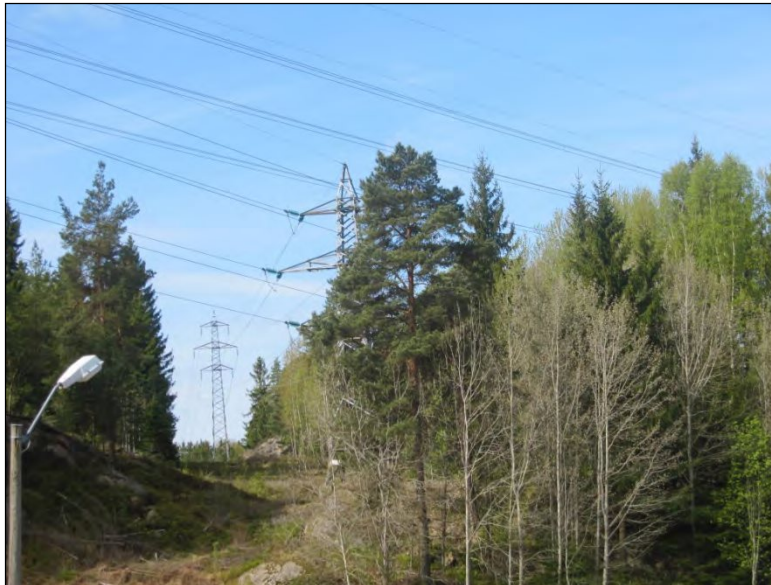
Figur 3. Foto av eks. 52 kV (Brekke ledningen). Vestre ende av ledningen inn mot Gyldenløve/Halden. To kurs stålmast.
