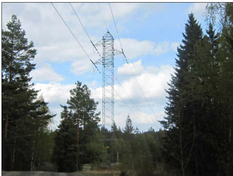
Figur 4. Foto av eks. 52 kV (Brekke ledningen) Østre ende av ledningen inn mot Brekke. Rundstålmast med trekant-oppheng.
