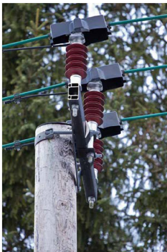
Figur 11: Eksempel på linje med travers, her med påmontert plastbeskyttelse
