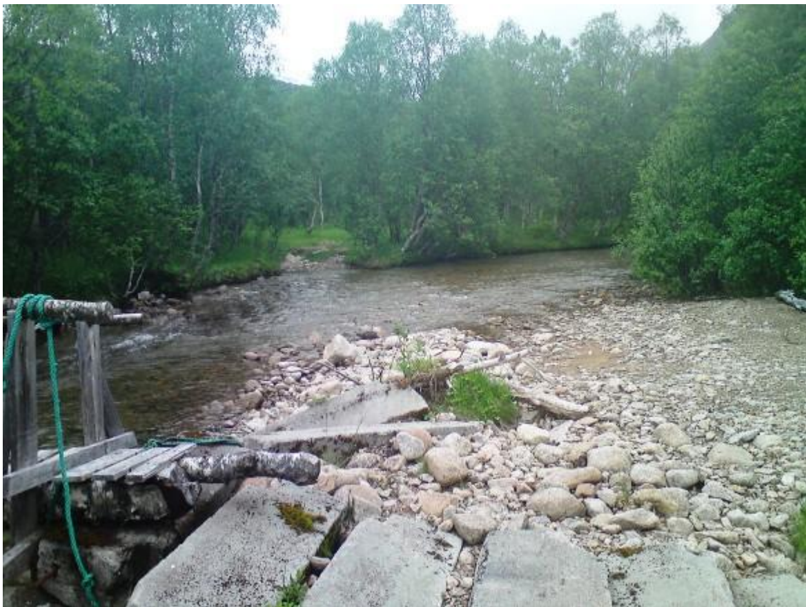
Bilde 6: Skogsveien som følger vestsiden av Dalelva ender i et vadested ca 1 km fra E10. Vadestedet utbedres slik at det blir fremkommelig med anleggsmaskiner.
