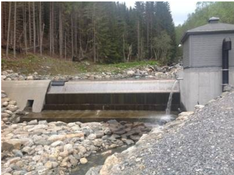
Inntaket til Dyrkorn Kraft med coandarist
