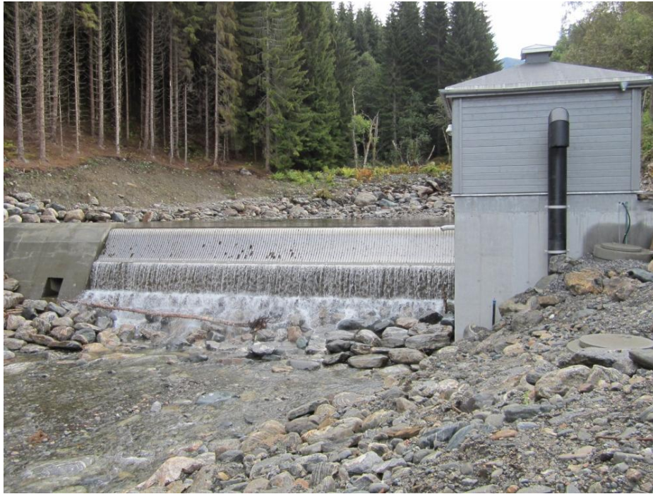
Figur 3: Coandainntak ved Dyrkorn Kraftverk (Foto: H. Opaker)
