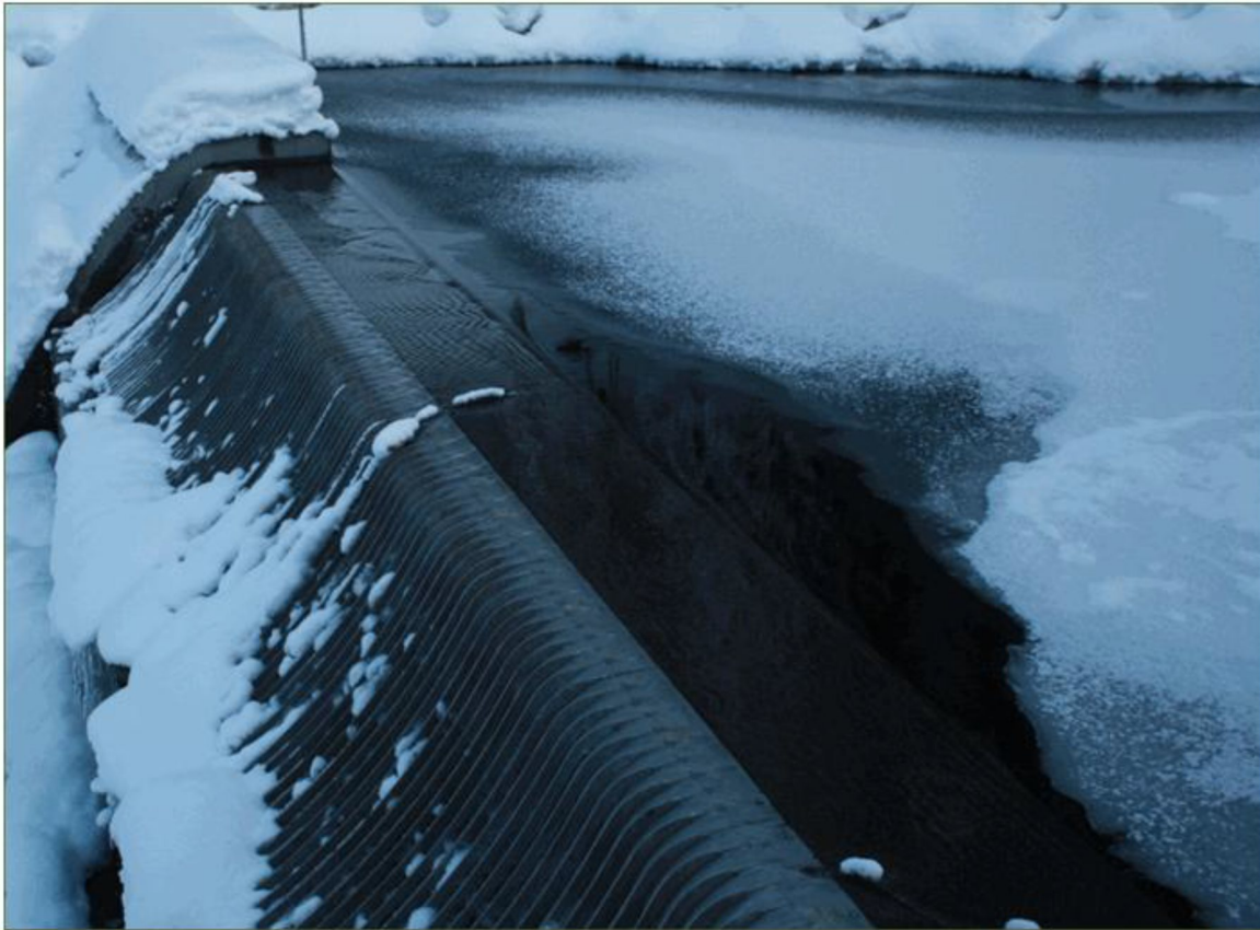
Figur 2.2.4.2 Coandainntak ein kald vinterdag med låg vassføring.
