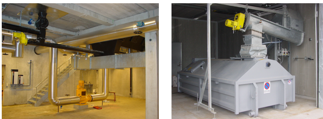
Eksempel på retur flygeaske til kjel samt lukket askecontainer for bunnaske (foto Sweco Norge AS)
