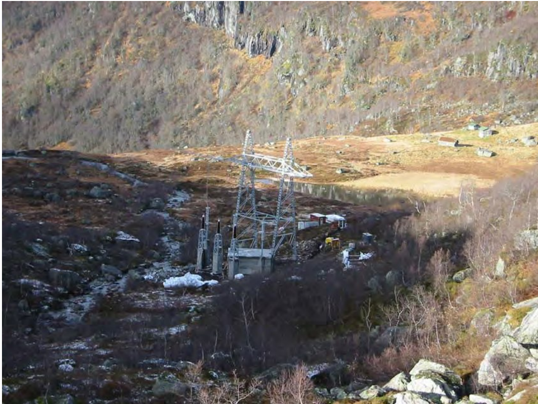
Foto 9 Aktuelt tilkoblingspunkt ved muffehus til Nygard kraftverk. (foto tatt 2004)
