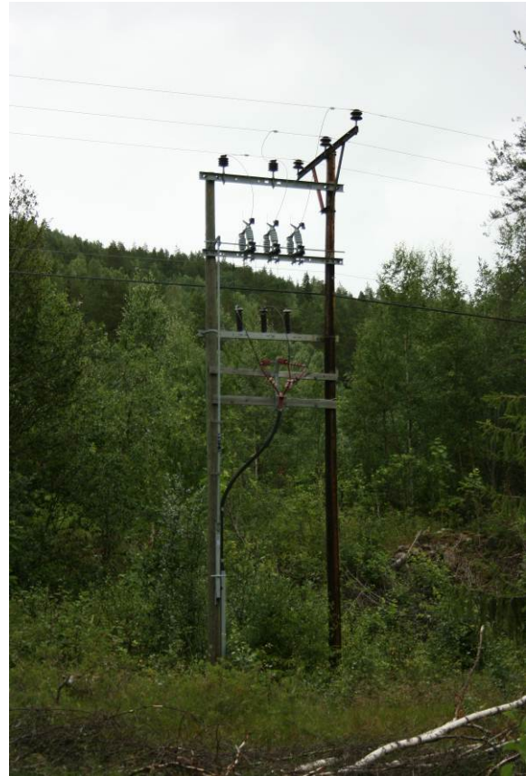
Bilde 6.2 Nærmeste 22 kV stolpe m T-gren
