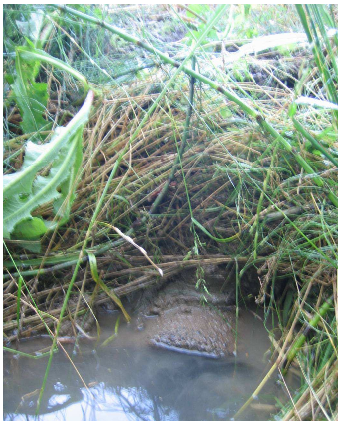
Figur 3. Oversvømt dreneringsrør fra byggåker på Haugen gård.
