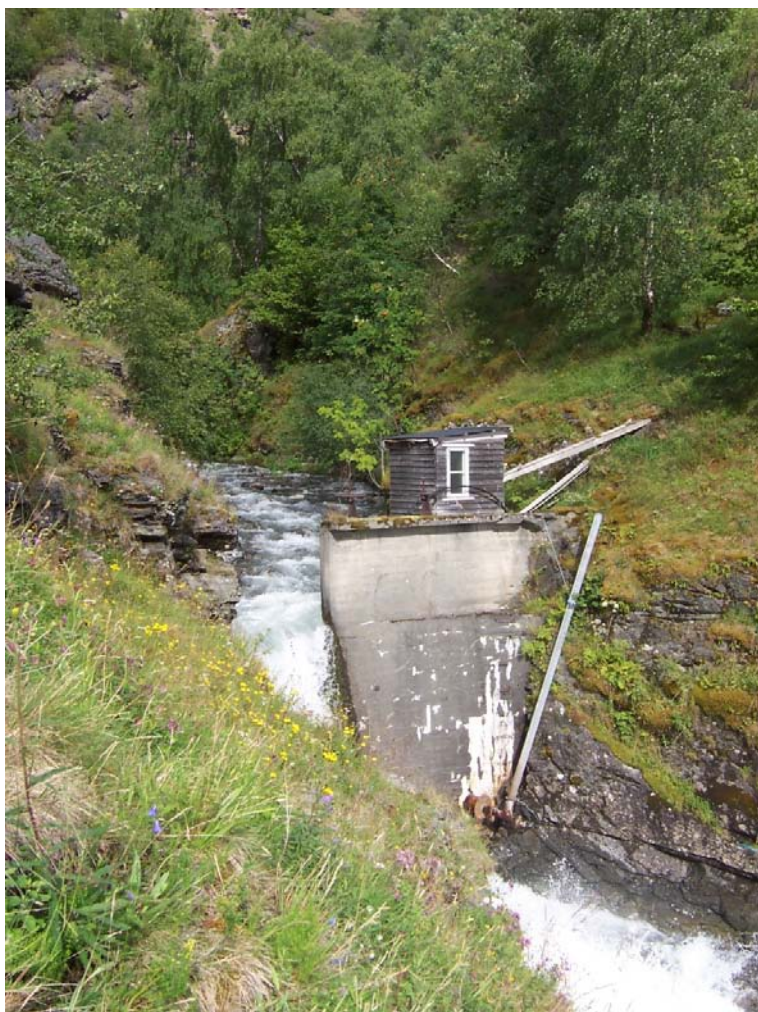
Gammel inntaks rett oppstrøms elvas utløp i fjorden.
