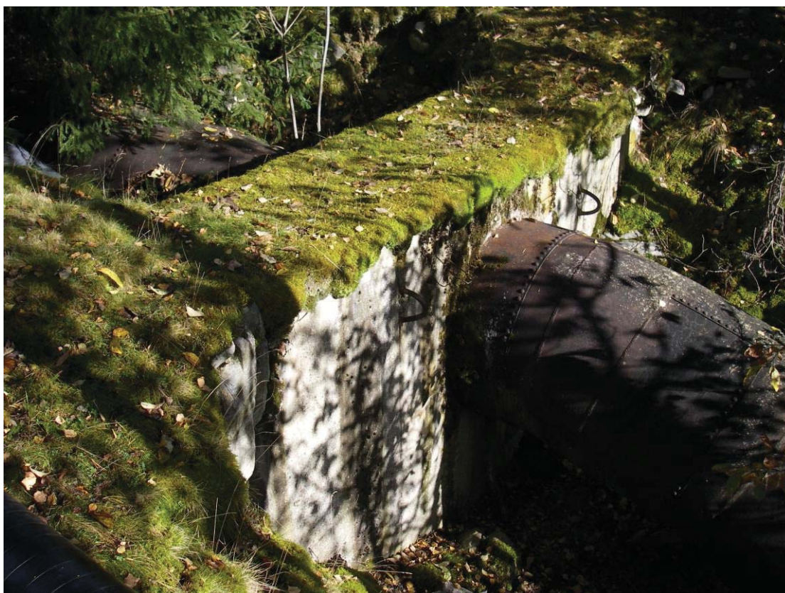
På det siste bratthenget ned mot kraftstasjonen var det benyttet jernrør på den gamle vannveien
