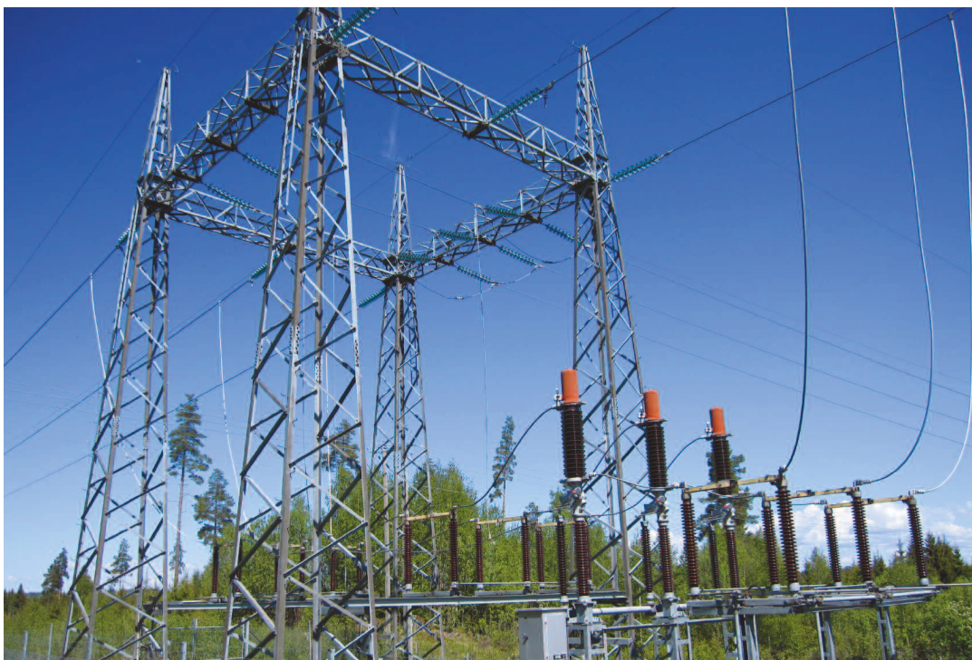
Fig. 9 Eks. T-avgreining mot Krabyskogen. Avgreining fra eks. 132 kV ledning Vardal-Minne
