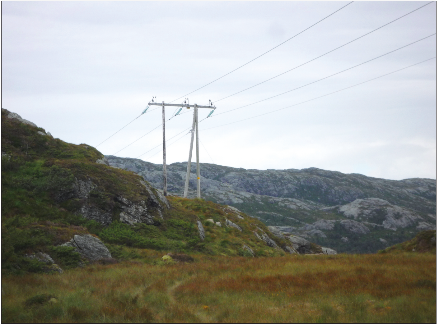
Bilde 5.4 Eksisterende 22/66 kV linje gjennom Bukkanibba vindkraftverk. Foto: Norconsult.
